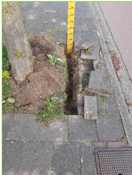
Profielsleuf bij boom 20. Ter hoogte van de sleuf komt in de nieuwe situatie de bandenlijn.
