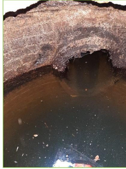
Inspectieput van het riool. Rond de buis bevindt zich fijne beworteling (lastig zichtbaar).
