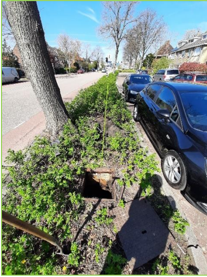
Inspectieput bij boom 13, deze staat niet op de KLIC-melding. De groene lijn geeft de ligging van het riool vanuit deze put weer.
