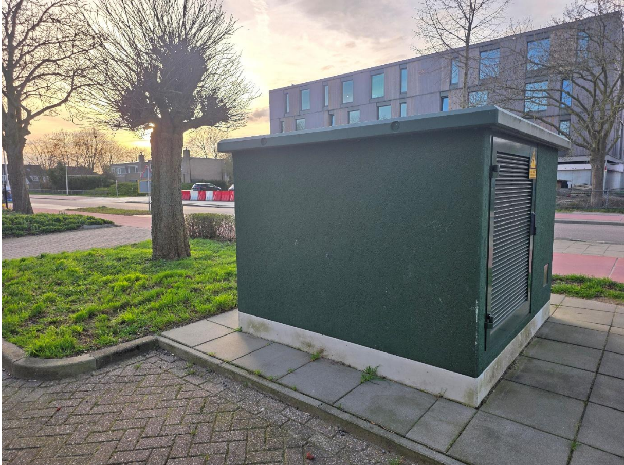
Foto 2: Een trafo aan de Hoogmadeseweg in Leiderdorp.
