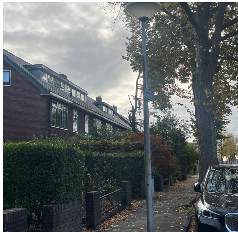
Boomnr. 11 met versmald trottoir en ontbrekende opsluitbanden. Deze situatie geldt de bomen 08 t/m 13.
